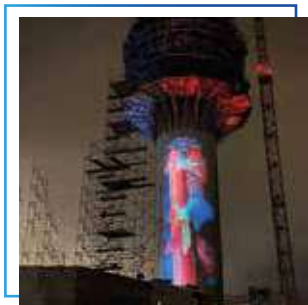
Presentación de nueva torre de control en el Aeropuerto Internacional Jorge Chávez.
