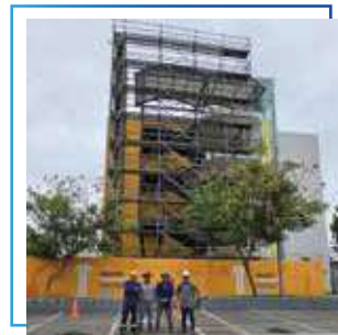
Presurización de escaleras en la Universidad Privada del Norte en Trujillo.
